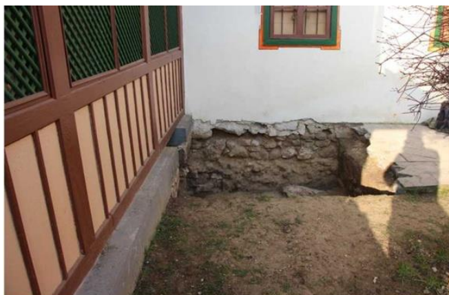
Рис. 6.22. Шурф 1. Фрагмент фундамента в осях Г/12 имеет дефекты и повреждения
