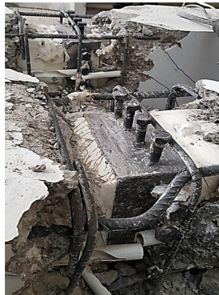
Усиливающие стальные ребра жесткости после испытания
