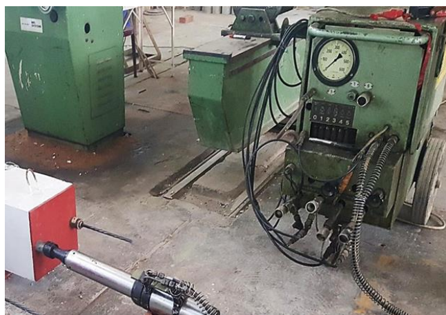
Рисунок 2-7 – Установка для предварительного напряжения
