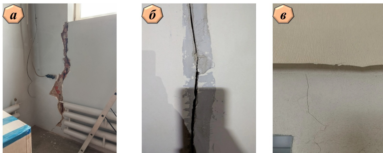
Рисунок 2.2. Результаты фотофиксации трещин (а – трещина в стене из кирпичной кладки; б – трещина в стене из железобетона; в – трещина в стене из блоков из пенобетона).
