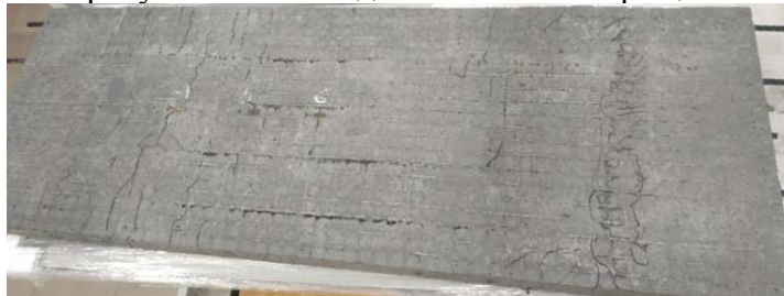
Рисунок 21. Образование трещин плита типа 3
