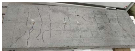
Рисунок 18. Образование трещин плита типа 1
