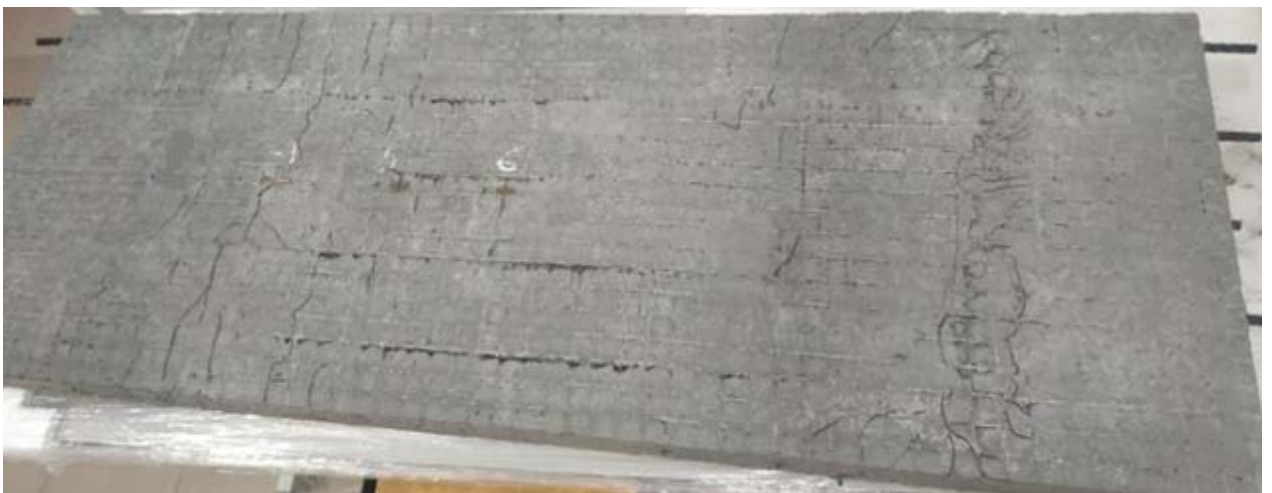
Рисунок 3.33 - Образование трещин в керамзитобетонной плите с базальтовой арматурой и сеткой (плита типа 3)
