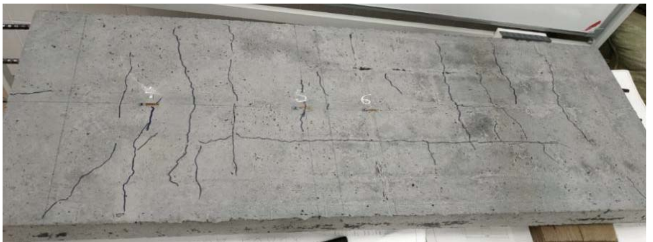
Рисунок 3.30 - Образование трещин на керамзитобетонной плите с базальтовой фиброй и базальтовой арматурой (плита типа 1)
