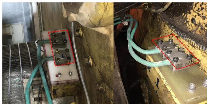
Рисунок 4 – Размещение датчиков акселерометра СА 202 в различных секциях газовой турбины на электростанции Киркука
