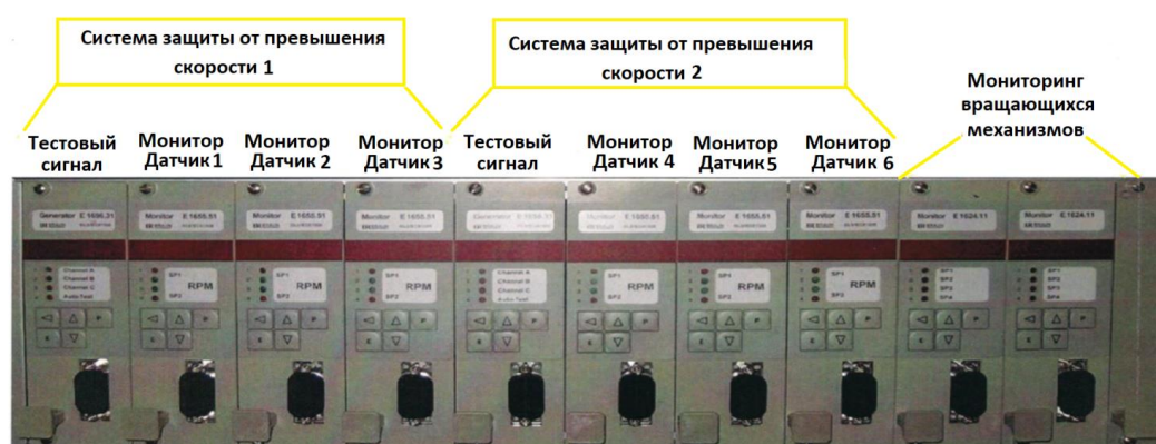
Рисунок 2 – Панель управления системой защиты от превышения скорости на газовой электростанции Киркука, включающая две независимые системы для обеспечения избыточности
