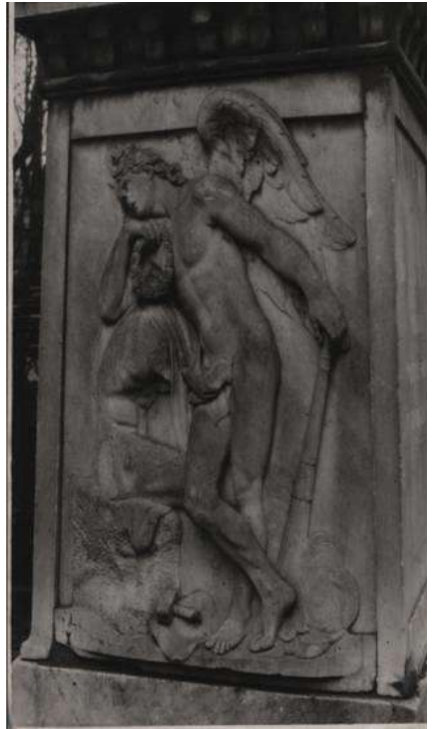
Рисунок 24 – Рельеф с фигурой Гения смерти надгробия М.И. Козловского (ск. В.И. Демут-Малиновский, 1803 г., мрамор). На выступающих участках рельефа наблюдается эрозионное разрушение мрамора, сопровождающееся загрязнением. Утрачен нос фигуры. Архив ГМГС. Фото № 670/2. Нег. № 2850
