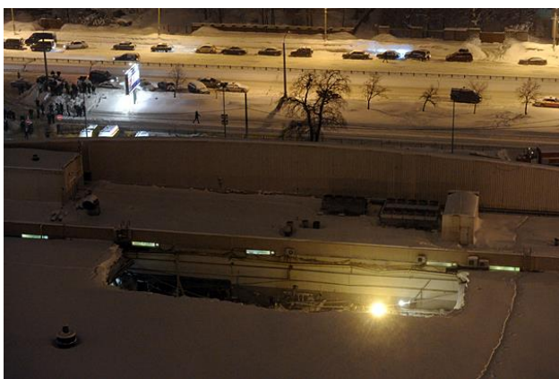
Рисунок 1.5. Обрушение части крыши гипермаркета «О'Кей», г. Санкт-Петербург 25.01.2011
