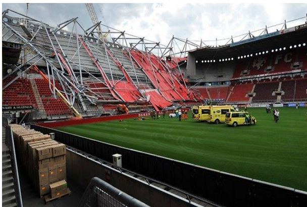
Рисунок 1.3. Обрушение части крыши на стадионе De Grolsch Veste, г. Энсхед, Голландия 7.07.2011
