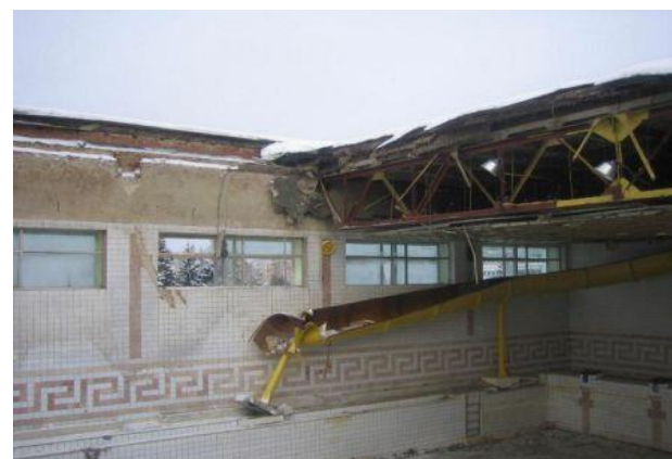
Рисунок 1.6. Обрушение потолочных перекрытий в бассейне «Дельфин», г. Чусовой Пермской обл. 04.12.2005
