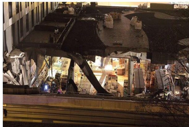
Рисунок 1.4. Обрушение торгового центра «Махима», г. Рига 21.11.2013
