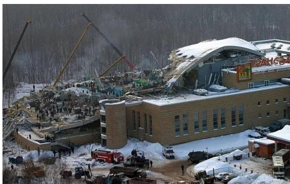
Рисунок 1.1. Обрушение здания аквапарка «Трансвааль-парк», г. Москва 14.02.2004
