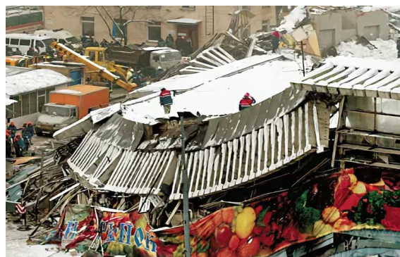
Рисунок 1.2. Обрушение покрытия на рынке ГУП «Басманный», г. Москва 23.02.2006
